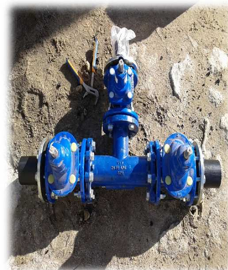
Nó de ligação da rede de água
