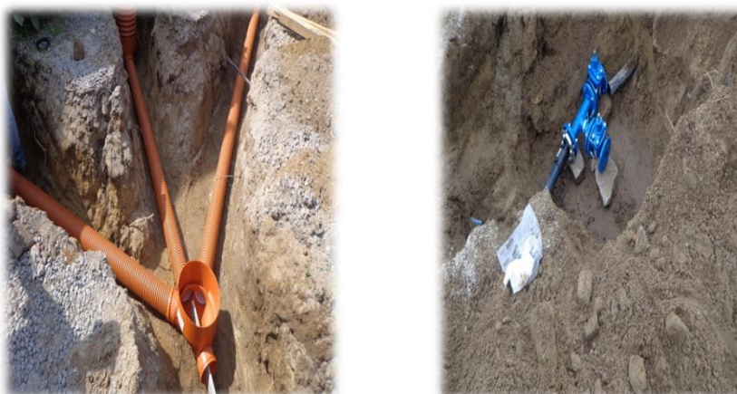
Figura n.º 13 e n.º 14 – Instalação de ramal de águas residuais e nó de água
