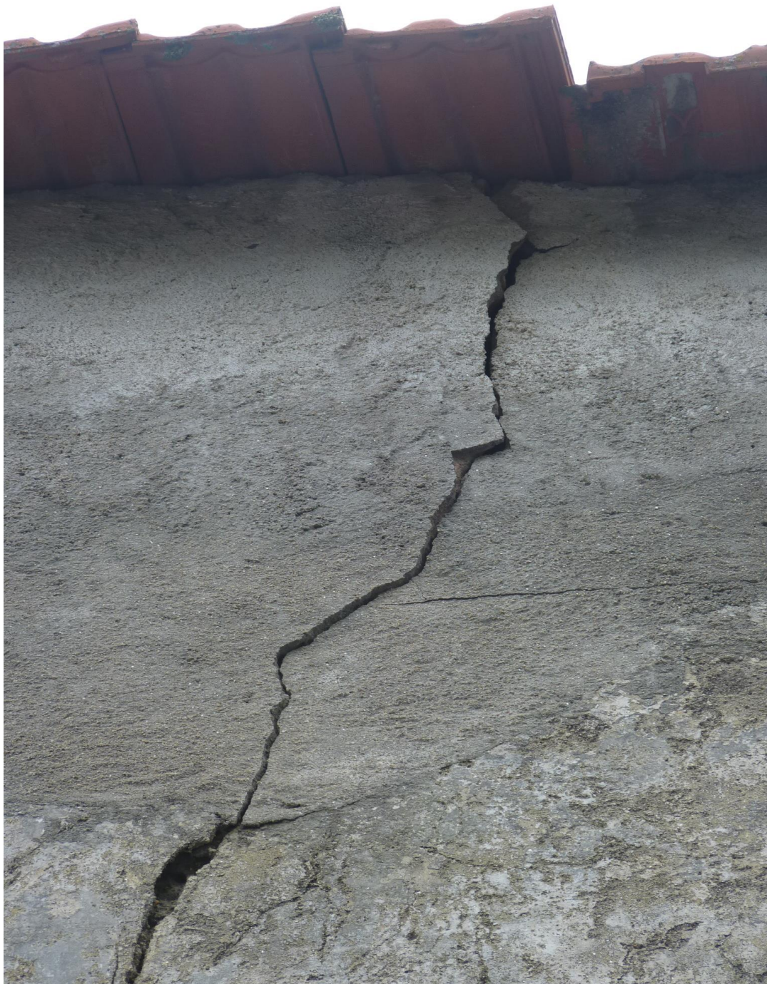
Foto 5 – Fenda estrutural – Parede exterior
